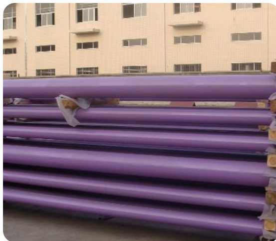
脱硫浆液管道
